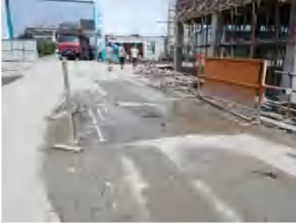
道路广场区洗车平台（2021.08）
